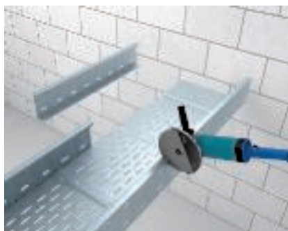
Т-образное ответвление с помощью угловой секции Извлечение боковых стенок кабельного лотка для больших расстояний.
